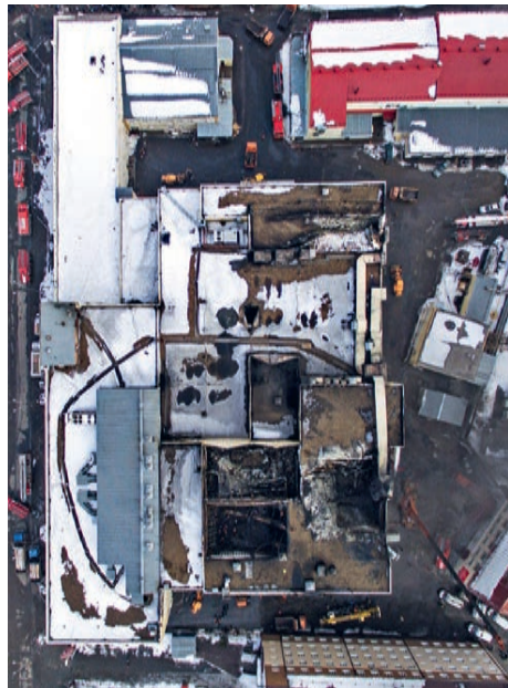
Обрушение кровли в ТРЦ «Зимняя вишня»
